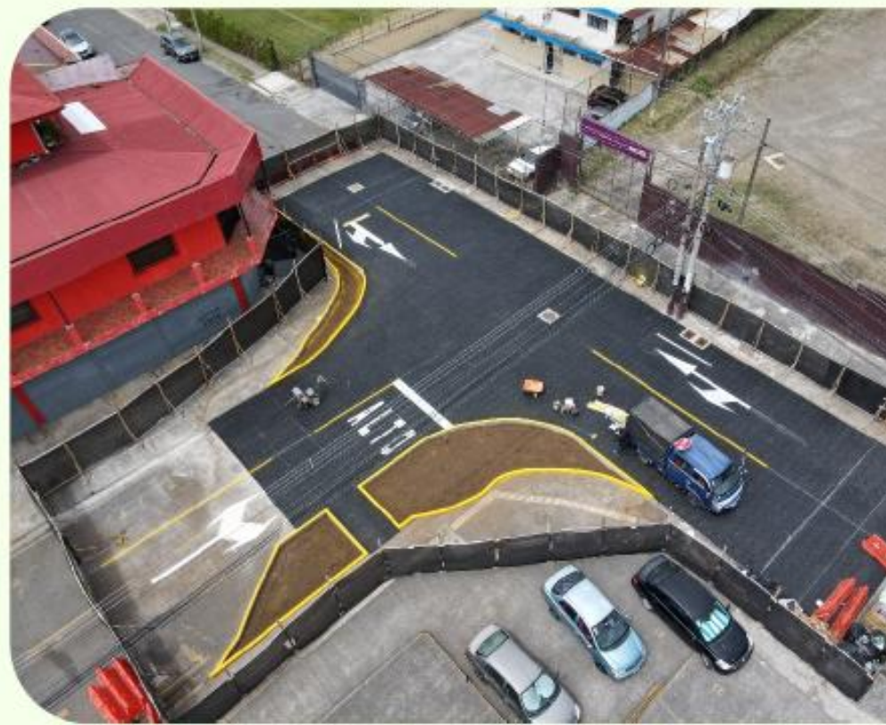
Intersección permeable Tibás, San José, Costa Rica
